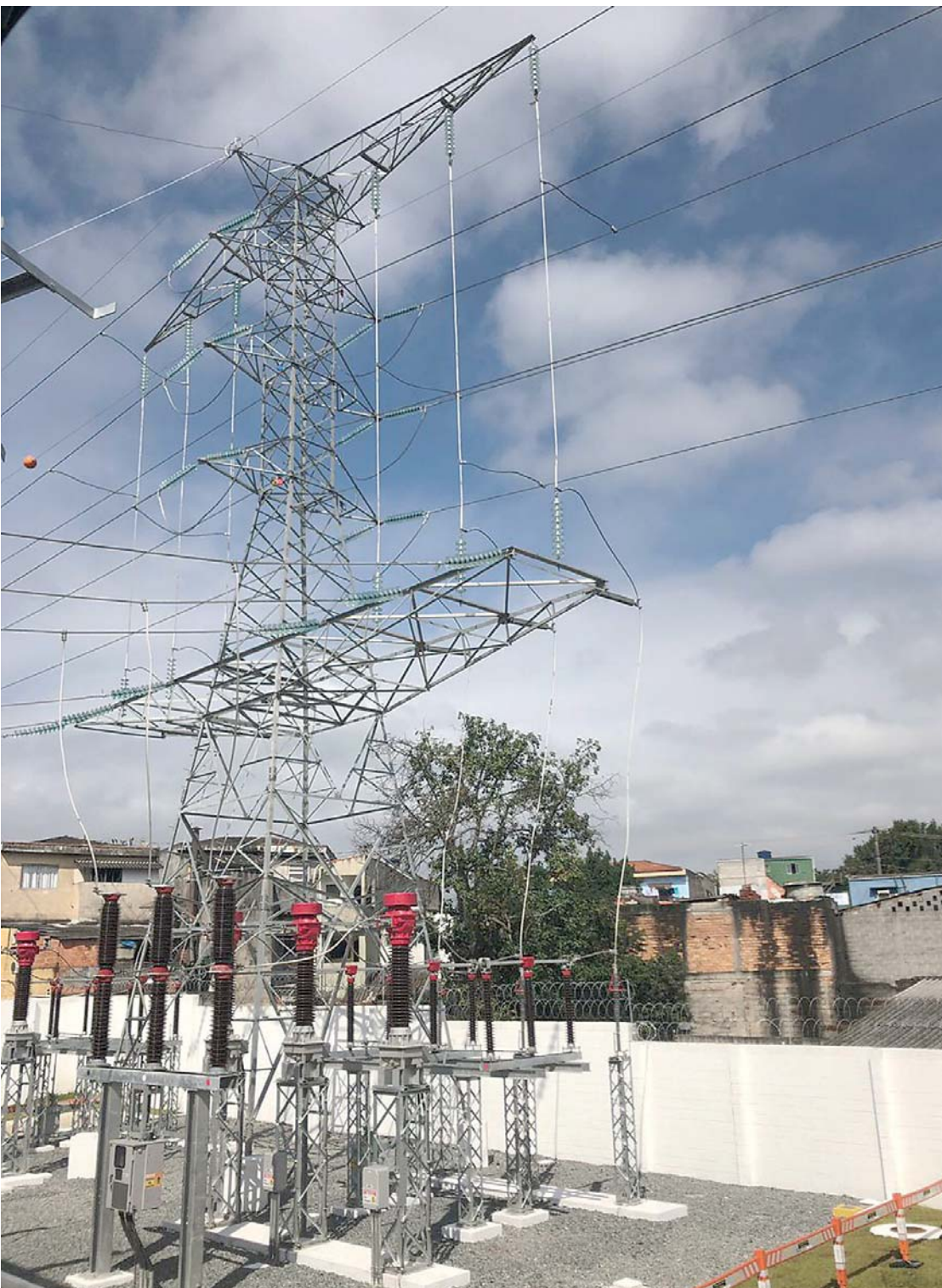
Com investimento de R$ 20 milhões, a nova unidade irá redistribuir energia de outras subestações
